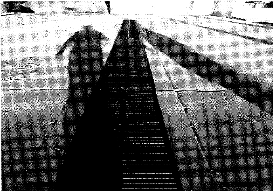
FOTO 08. CANALETAS DE CONCRETO CON REJILLAS METALICAS.
